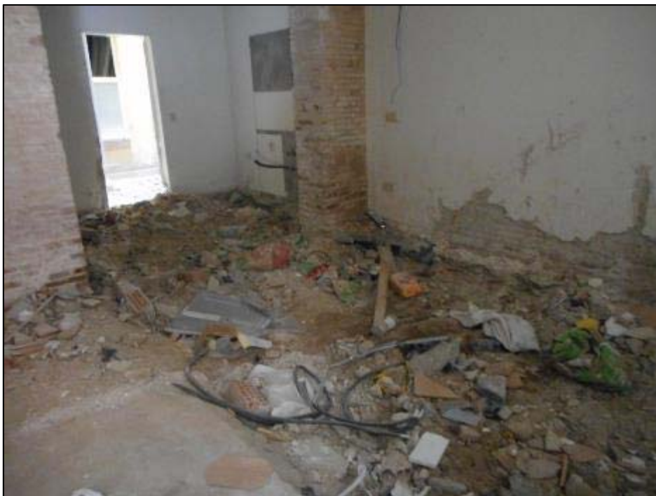
44. Àmbit 4, previ al rebaix general de 0.-50cm respecte la cota de paviment.
