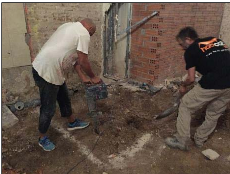
4. Inici dels treballs de buidat del nou fossat/sondeig dins el solar, establert com a mesura correctora.
